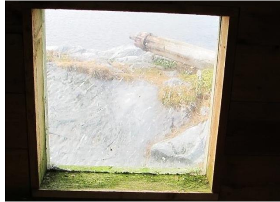
Tydelig algevekst i vinduskarmen i fuglekickerskjulet - Foto: Arne Petter Sarre / Statens naturoppsyn
